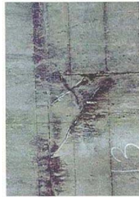
写真 2.1 ブロック化したひび割れの例 ㊦
