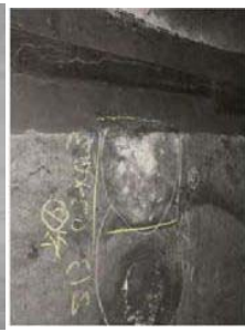
写真 3.7 覆工コンクリートが変色している例 1)
