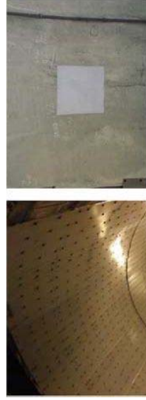
写真 3.10 補修モルタルが発化してはく離している例
