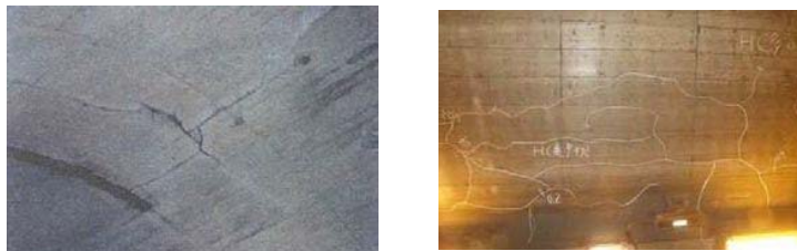
写真 3.6 複数のひび割れで覆工コンクリートがブロック化している例 ㊦
