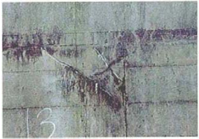
写真 2.1 ブロック化したひび割れの例 ①
