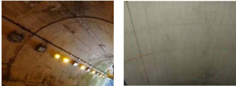
写真 3.4 覆工の天端付近に発生した縦断方向のひび割れの例 ㊦
