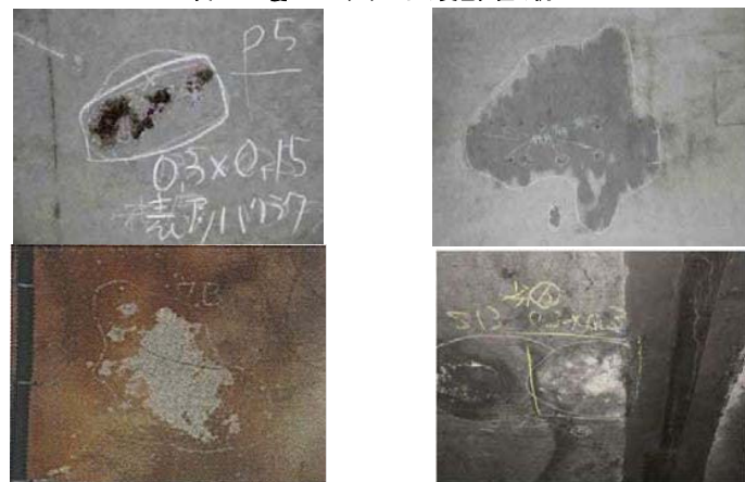
写真 3.7 覆工コンクリートが変色している例 ㊦
