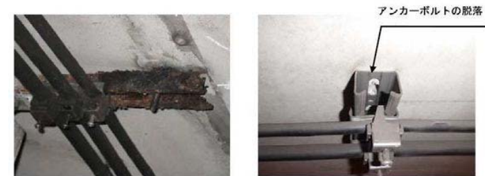
写真 3.13 固定金具の腐食とアンカーボルトの脱落の例 1)
