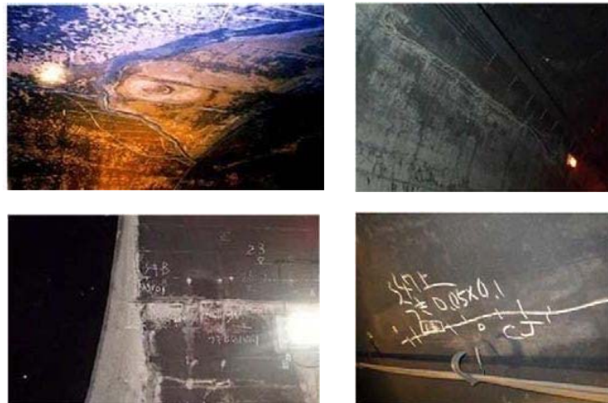
写真 3.12 コールドジョイント付近に発生したひび割れの例 1)
